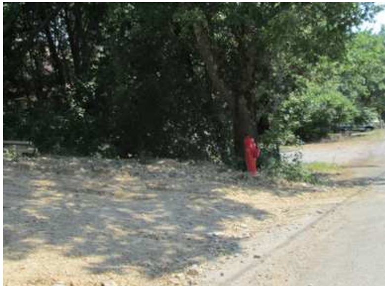
Poteau incendie au quartier du Trécol, photo : B. Reymond, ONF.
